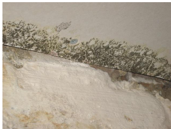
Figur 1: Muggen gipsplate i en kjeller med fukt- og muggproblemer. Bildet tatt av Afanou Anani Stami ©
